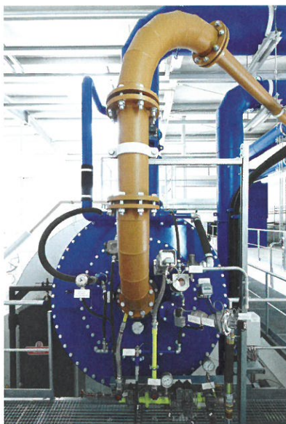
Der Brennerkopf ist der Eintritt in den Brenner und verfügt über Komponenten wie Lanze, Flammwächter, Brennlufzuführung, um eine saubere Verbrennung zu gewährleisten. Bild: Carbotechnik
